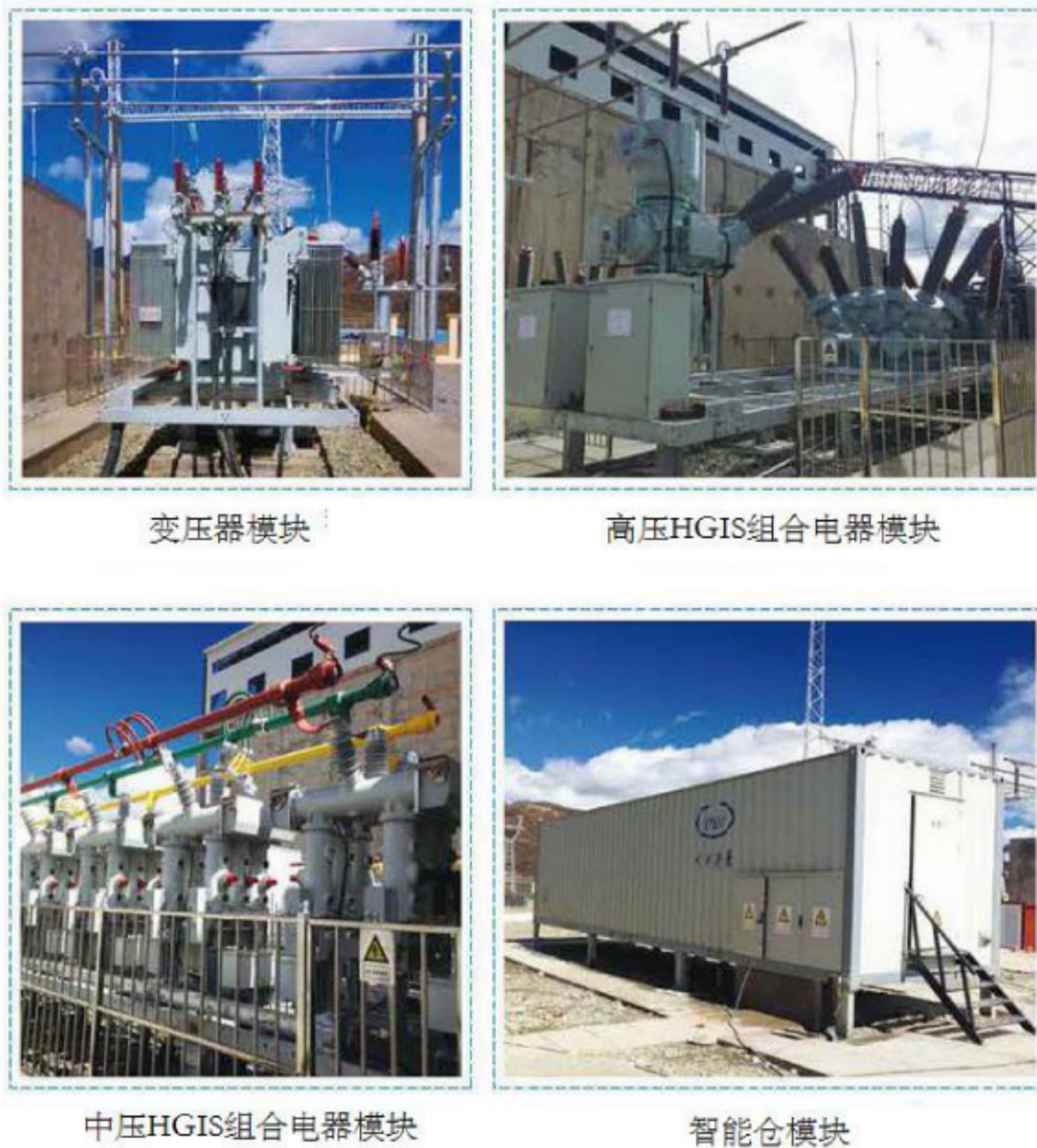
图 87：模块化变电站的主要功能模块
