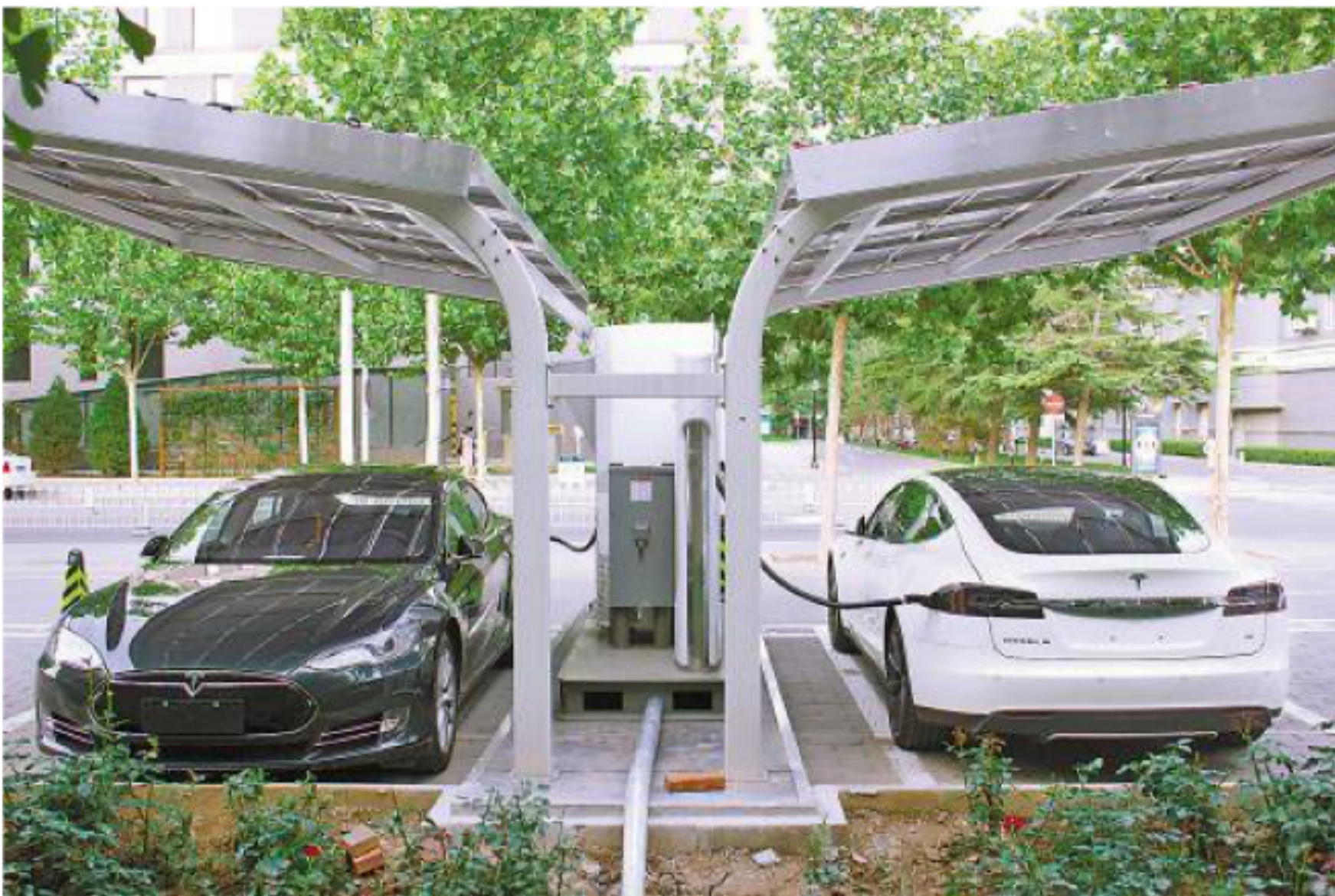
图 4：位于北京的 Tesla 超级充电站
